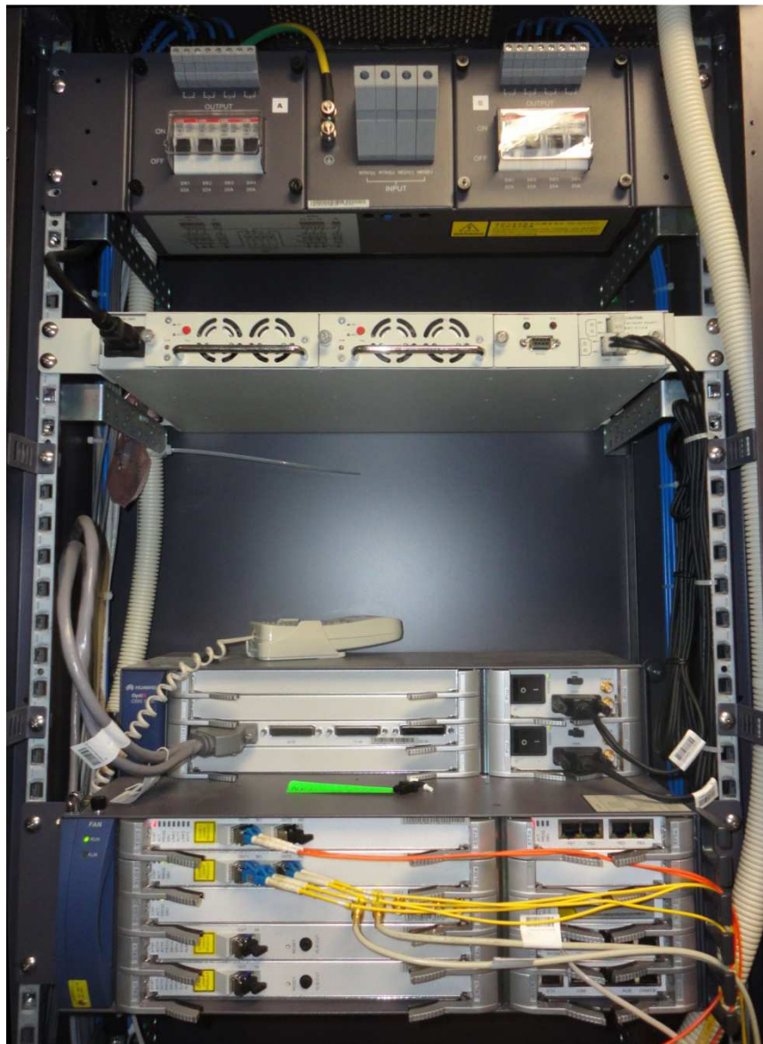
Figura I3. Equipos montados sobre bastidores metálicos
