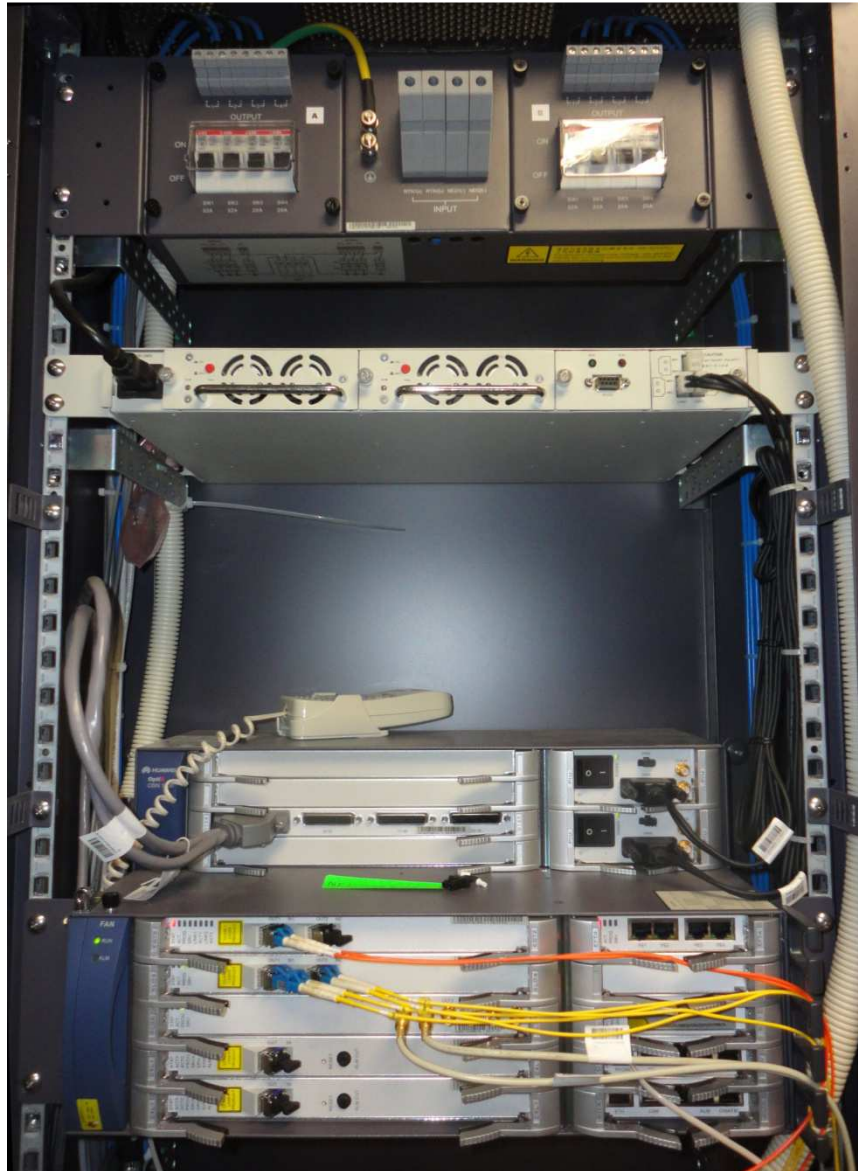
Figura I3. Equipos montados sobre bastidores metálicos
