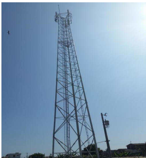
Figura 3.42 Lugar de Instalación de la Cuarta Sirena electrónica
