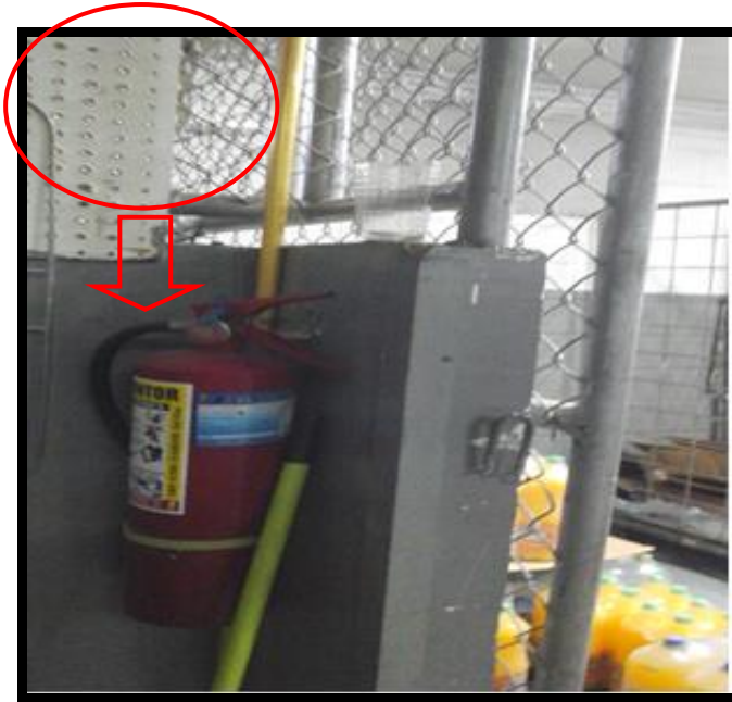
Figura 2.6: Falta Señalética de Extintor
