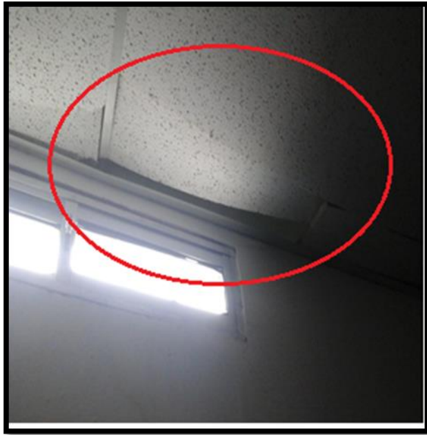
Figura 2.2: Deterioro en el Tumbado
