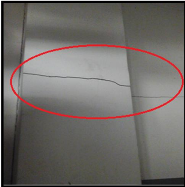
Figura 2.3. Agrietamiento de Vigas
