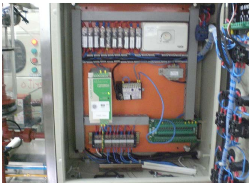
Parte Interna del Panel de Control
