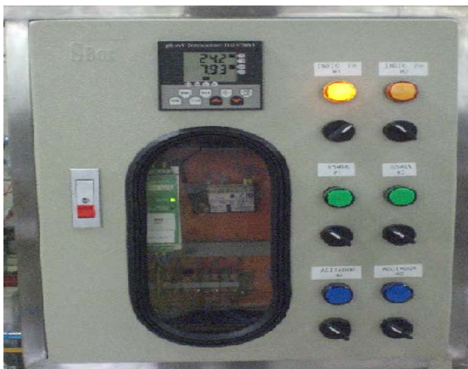
Figura 3.21 Parte externa del panel de control
