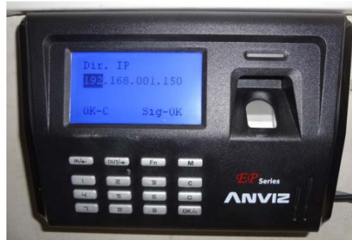
Figura 2.12 Control de acceso biométrico Anviz
