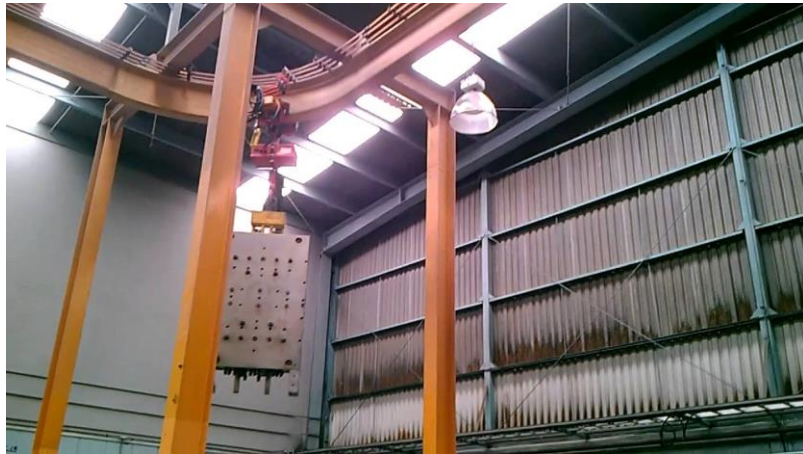
Figura 1.1 Puente Grúa Monorriel
