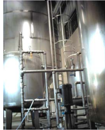
Filtros de Arena
