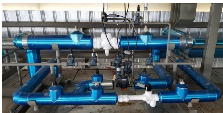
Figura 2.12 Tuberías de amoníaco
