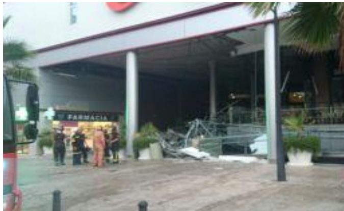
Figura 1.2: Parte del techo colapsado en Centro Comercial. [7]
