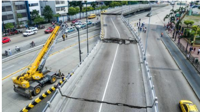
Figura 1.3: Caída del paso a desnivel Av. De las Américas
