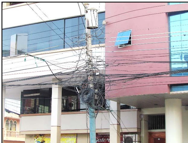
Figura 1.6: Reservas desordenadas en ubicaciones incorrectas, calle Buenavista entre la Av. 25 de Junio y Sucre
