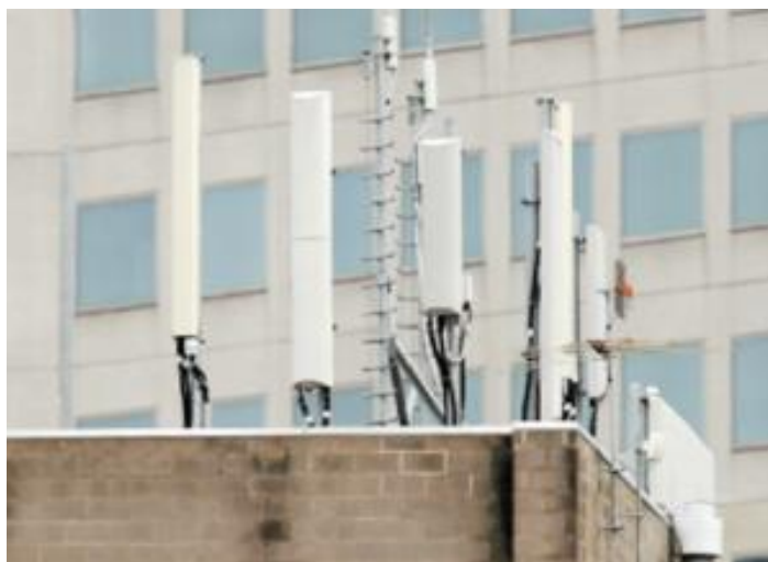
Figura 0.3. Antena Celular sobre un piso alto.
