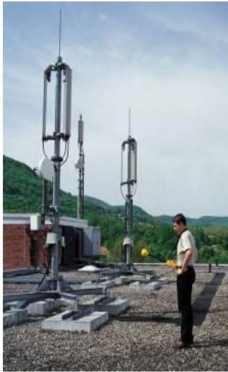
Figura 0.4 Medición de RNI en una antena celular mediante un analizador espectral portátil.
