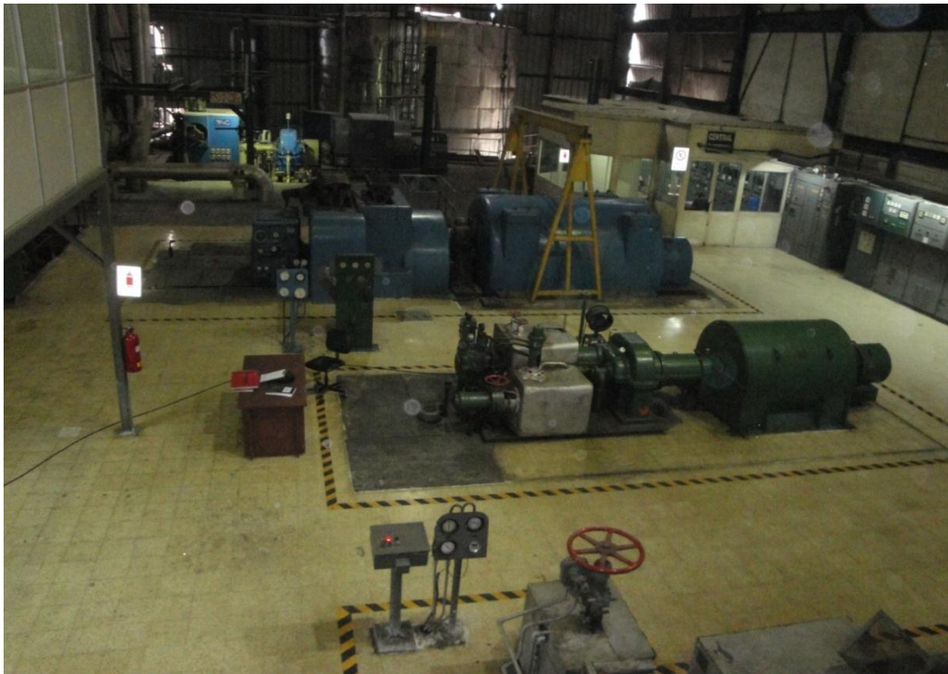
Figura 1.3: Generadores Eléctricos del Ingenio ECUDOS
