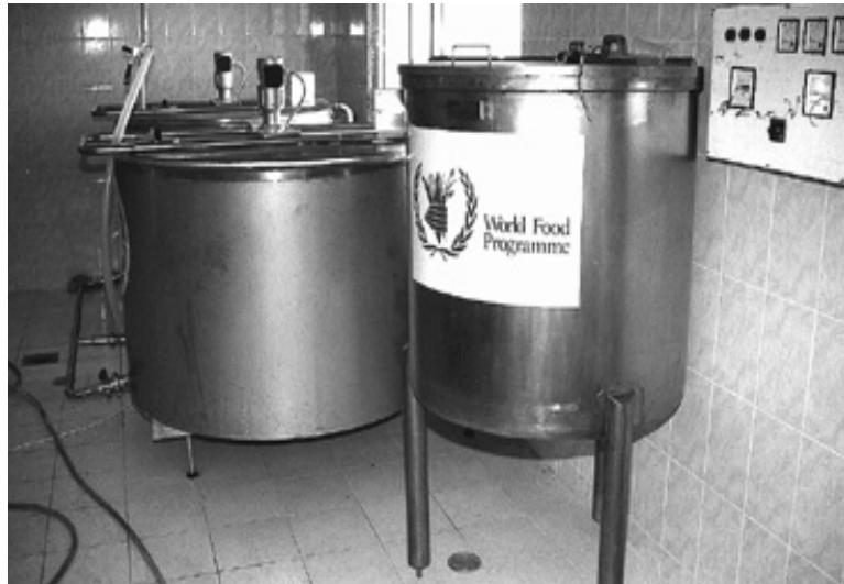
● Tanque de Almacenamiento y Pasteurización de leche.
