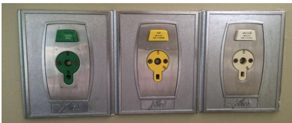
Figura A4.5: De Izquierda a Derecha: Toma de gas oxígeno, Aire medicinal y vacío
