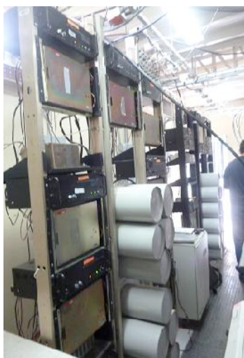
Figura A.4: Equipos troncalizados utilizados a través de la radio base Cerro Azul
