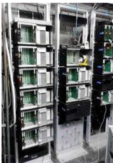
Figura A.5: Equipos troncalizados utilizados a través de la radio base Cerro Azul
