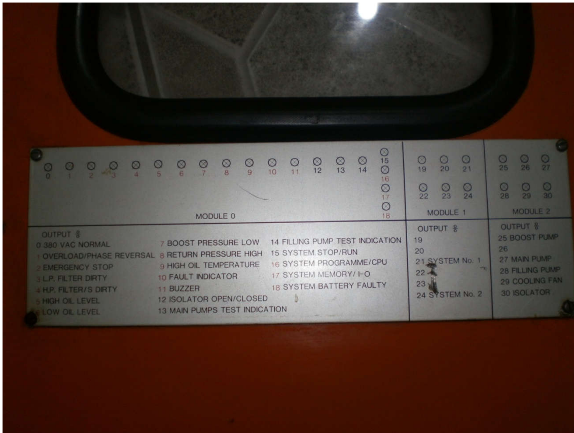
Figura 9. Distribución de señales digitales en el PLC antiguo
