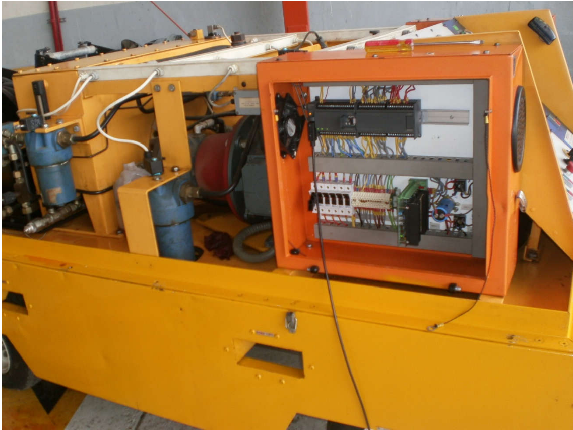
Figura 11. Cableado del controlador programable S7-1200
