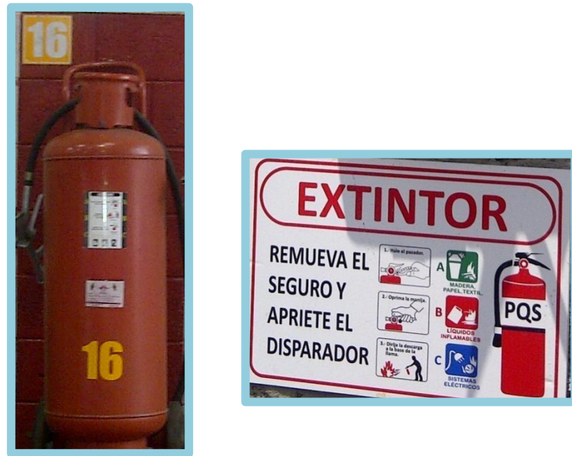
Foto 13 EXTINTORES Y SEÑALÉTICAS
