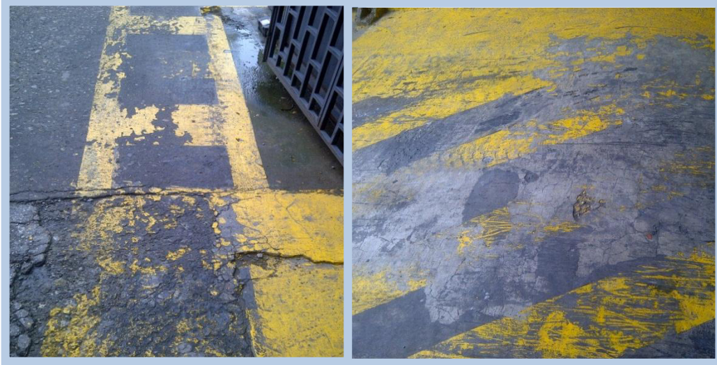
Foto 17 SEÑALIZACIÓN POCO VISIBLE
