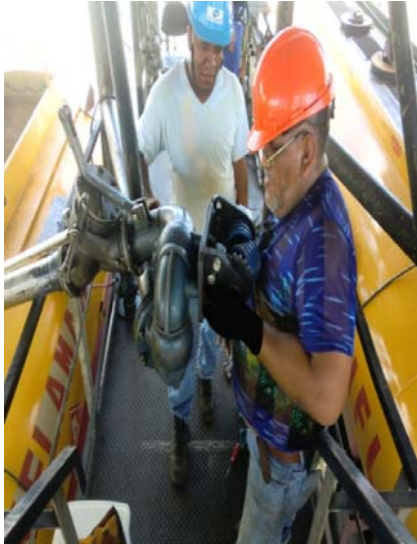
9.- Retirar el balancin dañado del brazo de carga.
