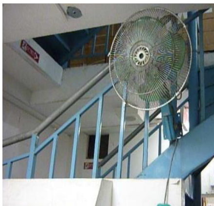
Figura 4.1.2 del ventilador en el área de despacho
