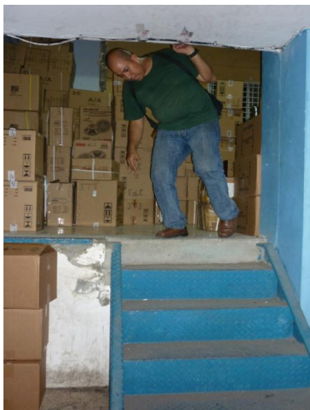
Figura 4.1.5 de las escaleras sin barandillas
