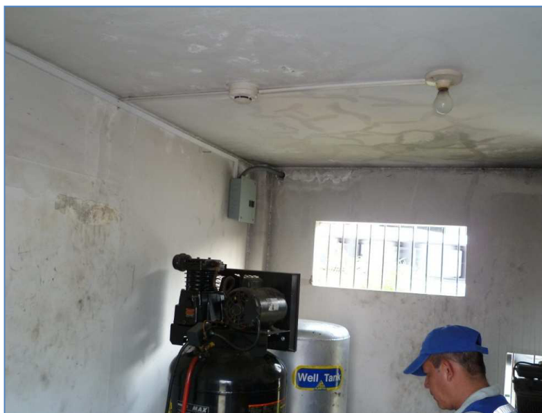
Figura 2.7. Cuarto de bomba y generador eléctrico.
