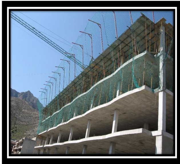
Figura 4.16 Redes Verticales de Seguridad
