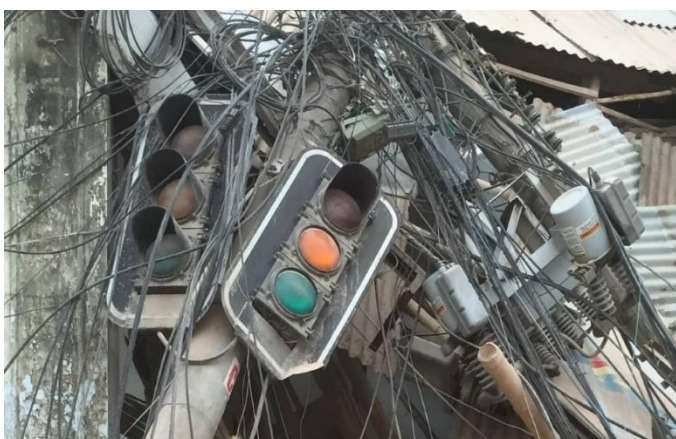
Figura 1.2: Postes de luz y teléfono afectados por el terremoto. [3]
