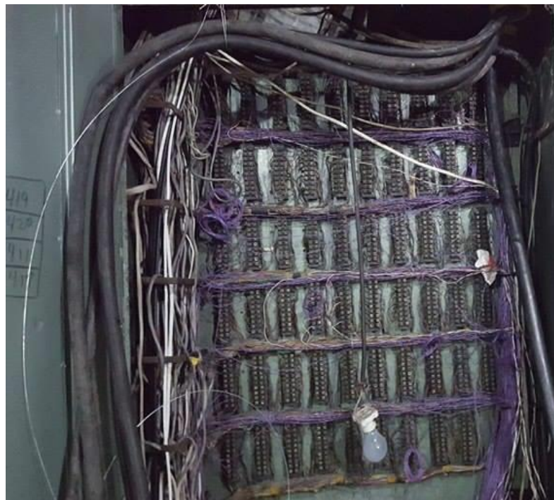
Figura 3.1 Situación actual de la caja de distribución de abonados dentro del edificio.
