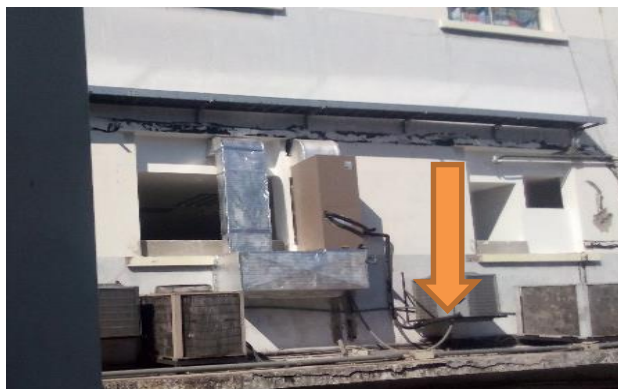
Figura 1.3: Cables de datos enviados por tubos de agua.
