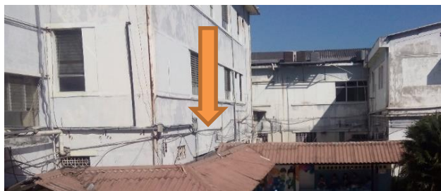
Figura 1.4: Cables de datos en los techos junto a cables eléctricos.
