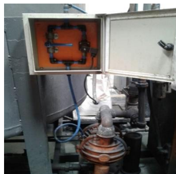
FIGURA 1.6 TABLEROS DE CONTROL BOMBAS NEUMÁTICAS
