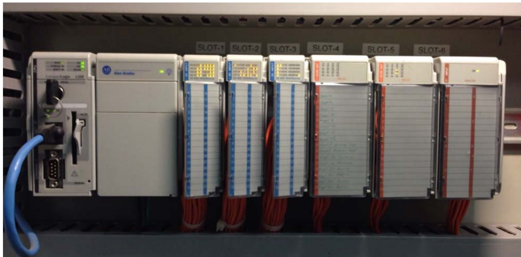
Figura 1.1: PLC CompactLogix, módulos I/O.
