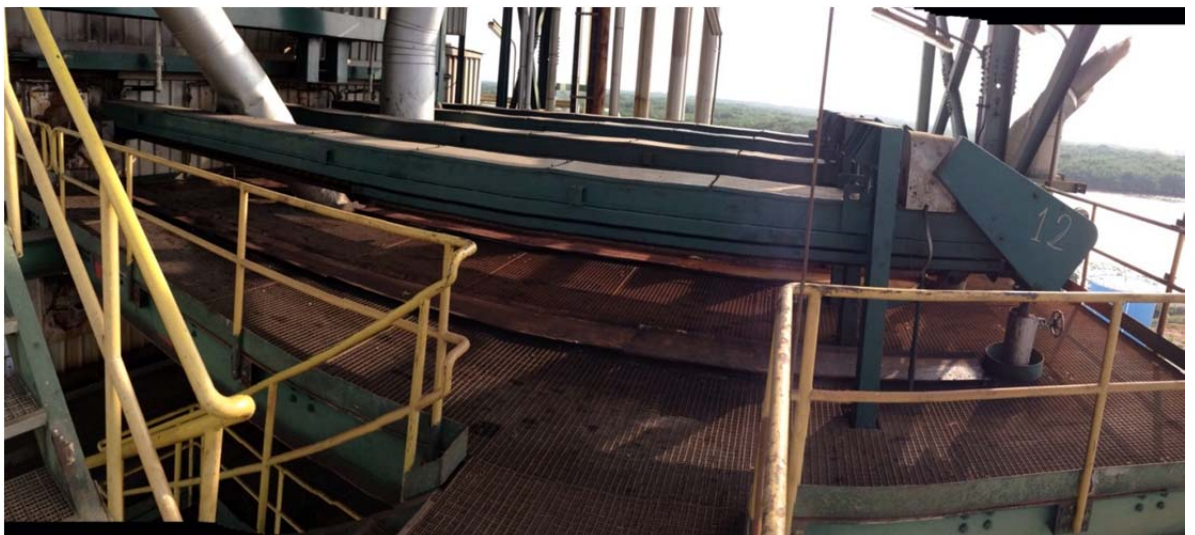
Soplador de caldera (SOBRECALENTADOR PRIMARIO)
