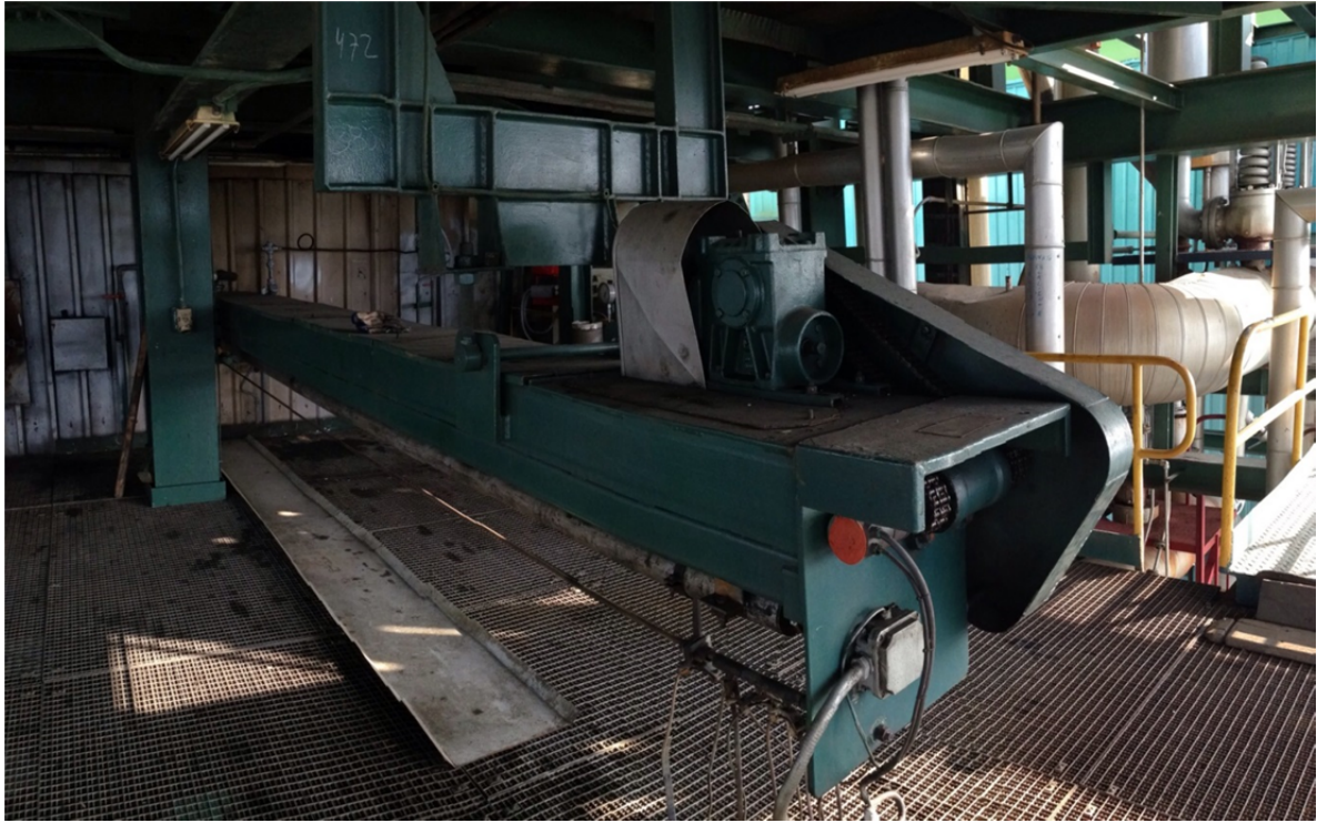
Soplador de caldera (SOBRECALENTADOR SECUNDARIO)
