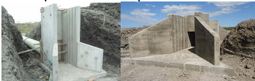
Figura 20 Compuertas de salida de piscinas camaroneras
