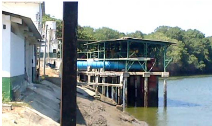
Figura 19 Estación de bombeo de camaronera Ecuacultivos s.a.
