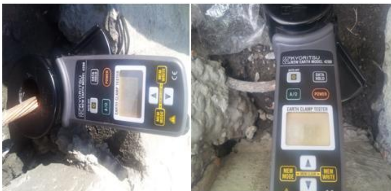
Figura 7.48 Mediciones de la Malla del Panel UPS 460 V
