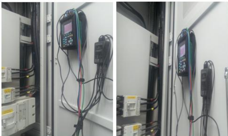
Figura 6.9 Tablero 460 V del CDI donde fue localizado el KYORITSU
