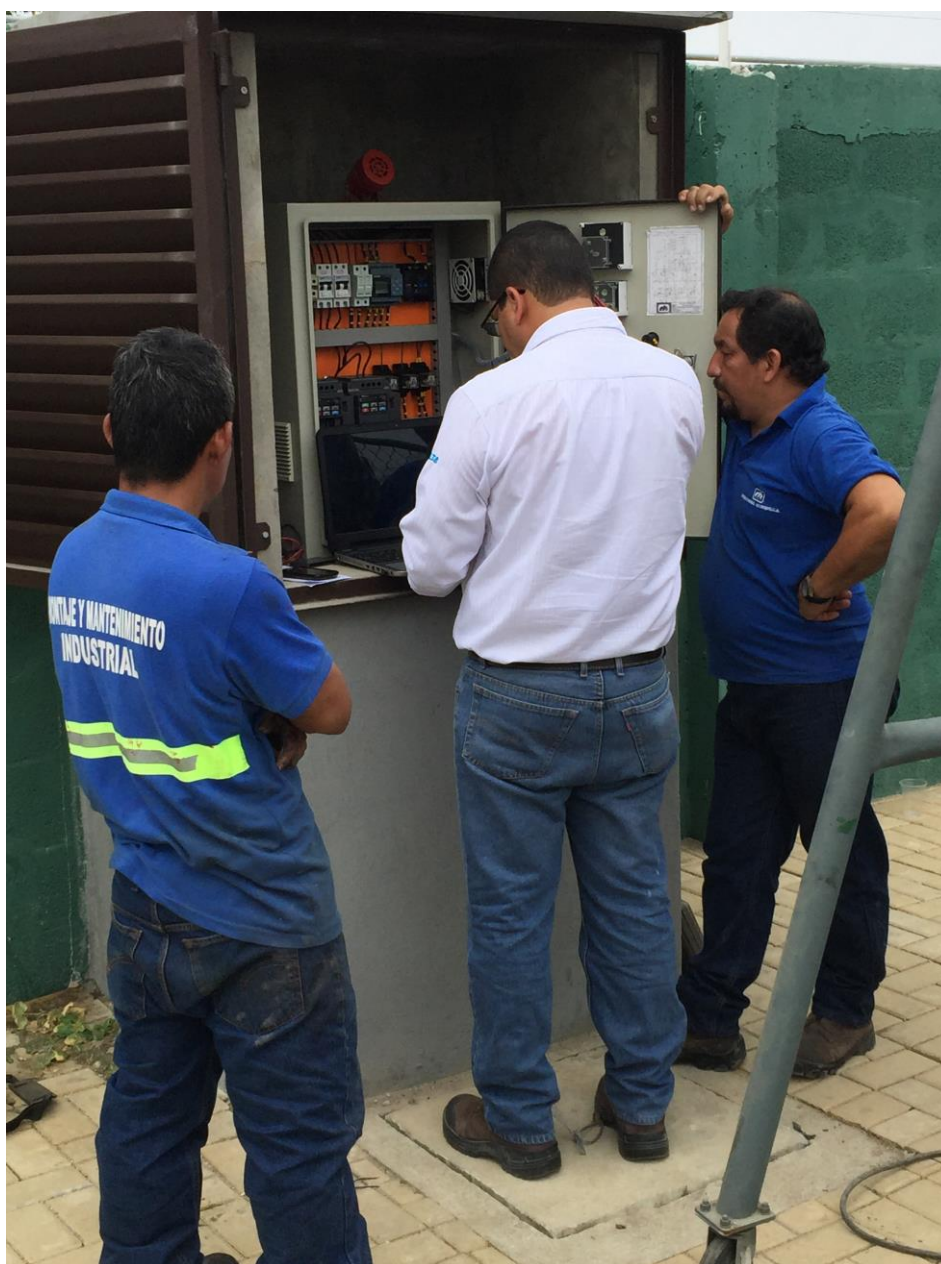
Figura 3.3: Reprogramación de variadores de frecuencia y/o PLC.
