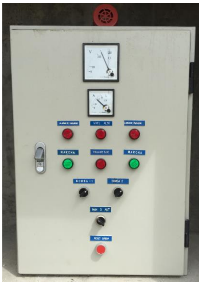
Figura 1.2: Puerta con indicadores de tablero de control de bombas sumergibles.
