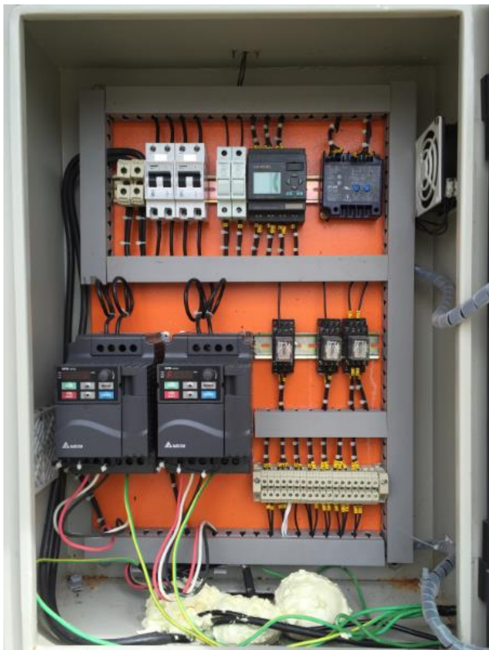
Figura 1.3: Interior de un tablero de control de bombas sumergibles.
