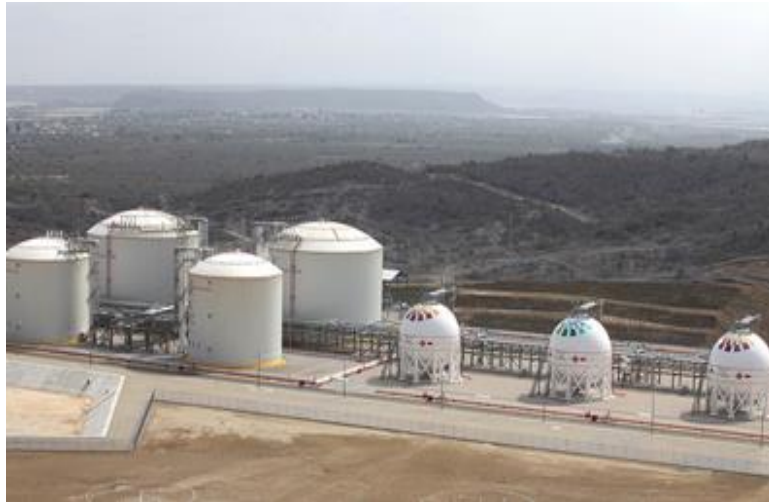
Figura 1.2 Tanques y esferas de GLP en estación “Monteverde”, Ecuador.
