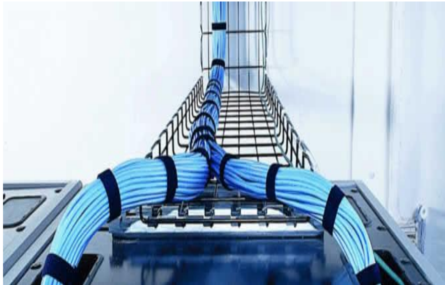
Figura 3.2 Sistema de bandejas porta cables
