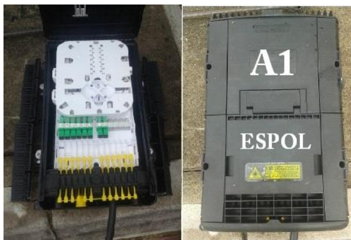
Figura 3.27: Fotos interna y externa de una NAP. [26]
