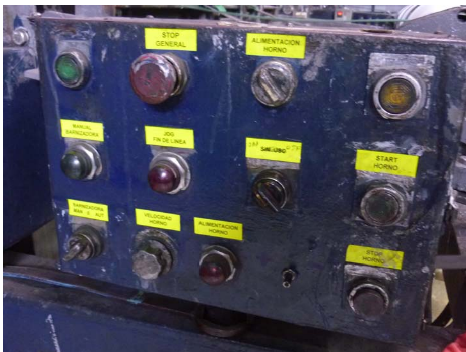
Foto 2.4 Panel de operación del horno
