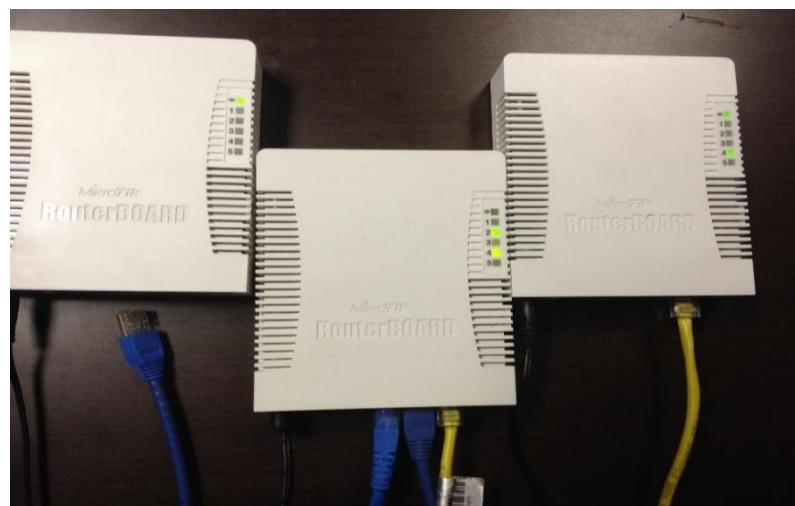
Figura 5.1312 Equipos Mikrotik Conectados (Pruebas)
