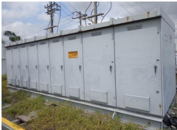
Figura 1.10 Armarios de Banco de Baterías
