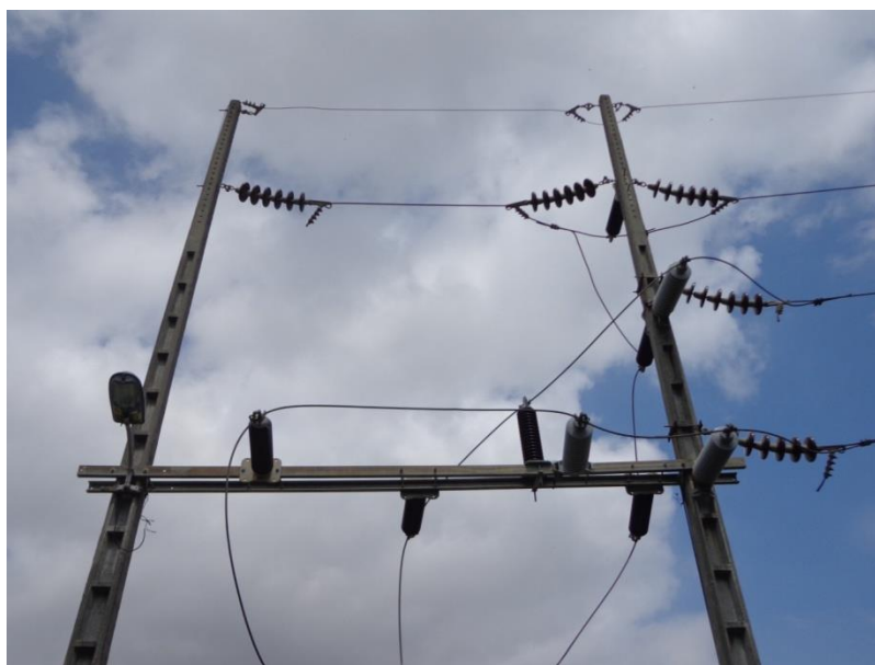
Figura 1.6 Estructura H de 69 KV presente en la S/E Durán Norte
