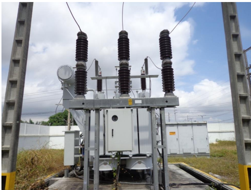
Figura 1.7 Interruptor 72,5 KV marca ABB tipo EDF SK 1-1
