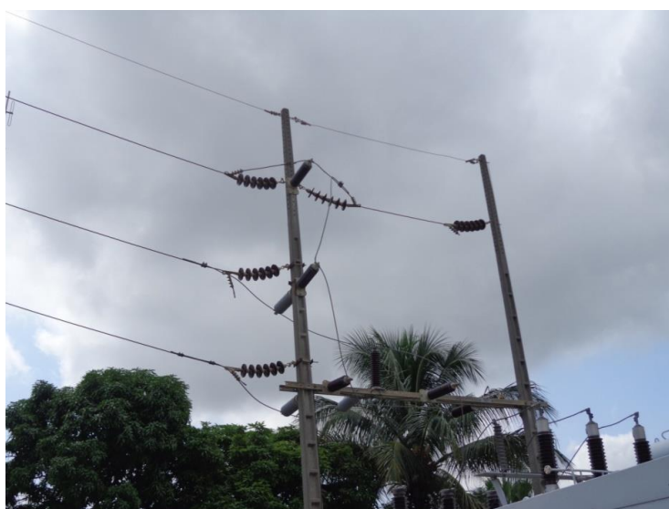
Figura 1.5 Estructura de 69 KV de la S/E Durán Norte
