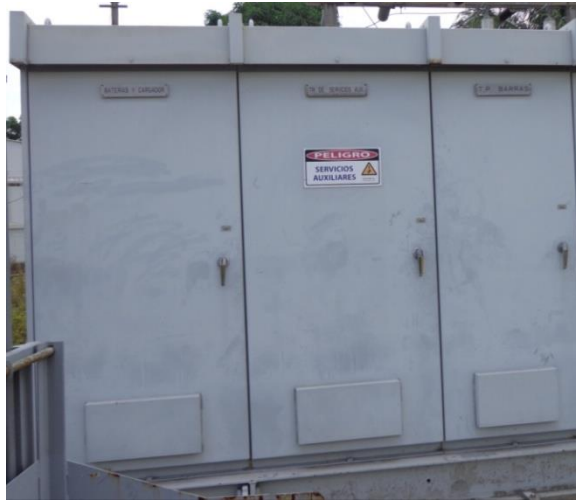
Figura 1.11 Fuente para Servicios Auxiliares
