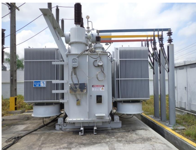
Figura 1.9 Transformador de potencia marca CHINT
