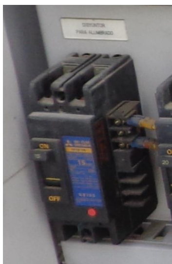
Figura 1.14 Disyuntor de servicios auxiliares
