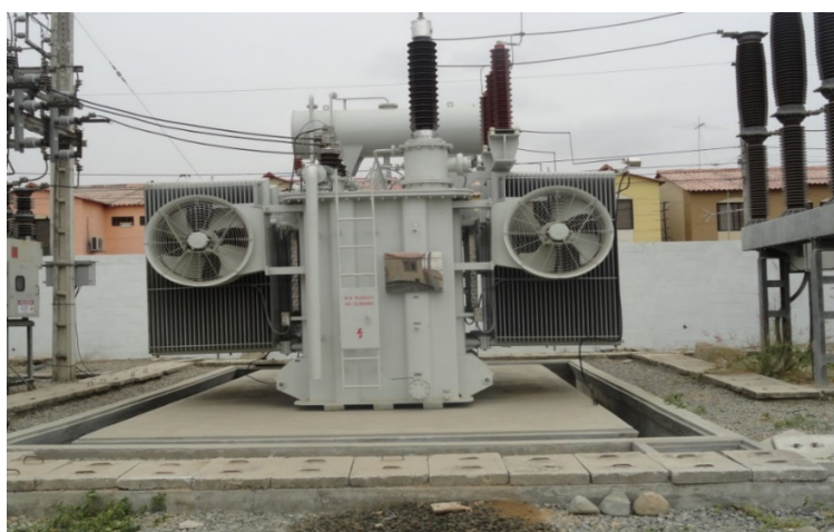
Figura 1.9 Transformador de potencia 24/30 MVA
