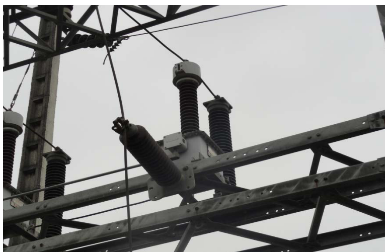
Figura 1.8 Seccionadores de aire con cuchillas de tierra
