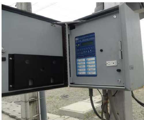
Figura 1.11 Vista del controlador tipo SEL-351R.
