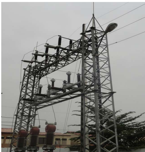
Figura 1.7 Vista de la estructura de 69 Kv
