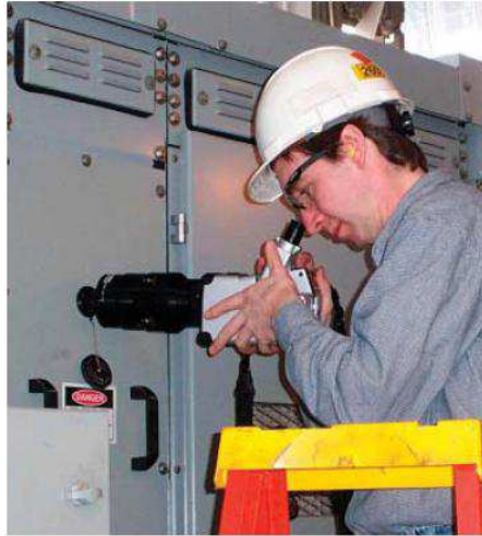
Figura 5.1: Manipulación en armarios sin guantes de protección
