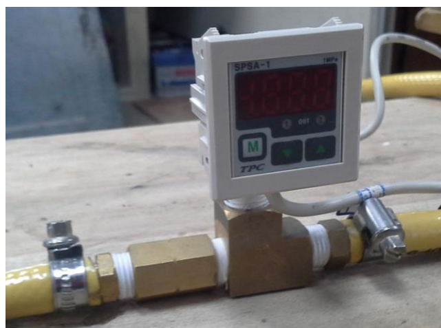
FIGURA 26. Medidor SPSA-1 instalado
