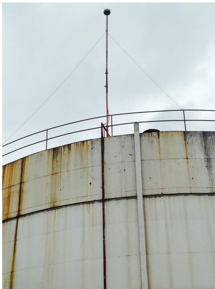
Figura 8. Pararrayos instalado en tanque de producto terminado (Alcohol)
