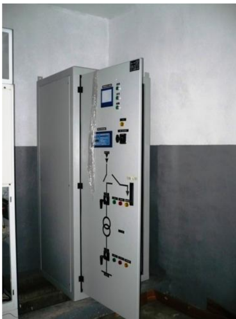
Figura 12. Tablero de Control y Protección
