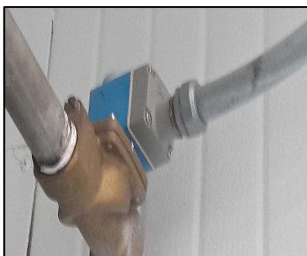
Figura 1.4: Válvula solenoide de Agua para “defrost”.
