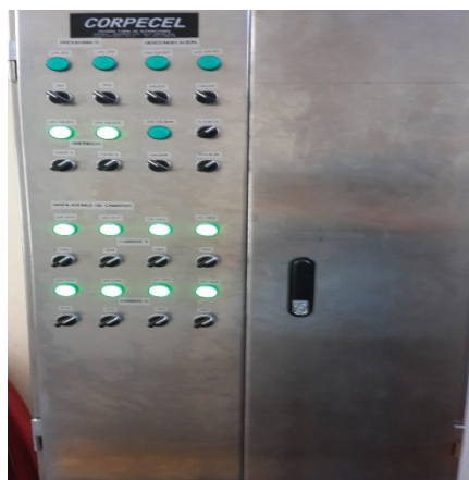
Figura 2.11: Tablero de cámaras de enfriamiento.
