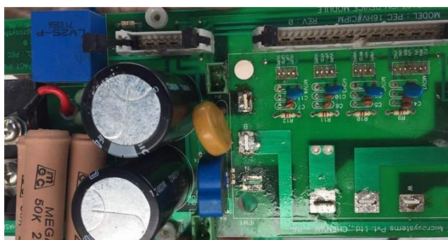
Figura 3.16 Soldadura fría y suciedad en la Tarjeta Electrónica de Potencia
