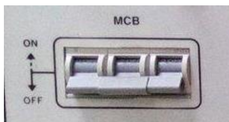
Figura 22 Breaker principal de encendido del equipo PEC16DSM01
