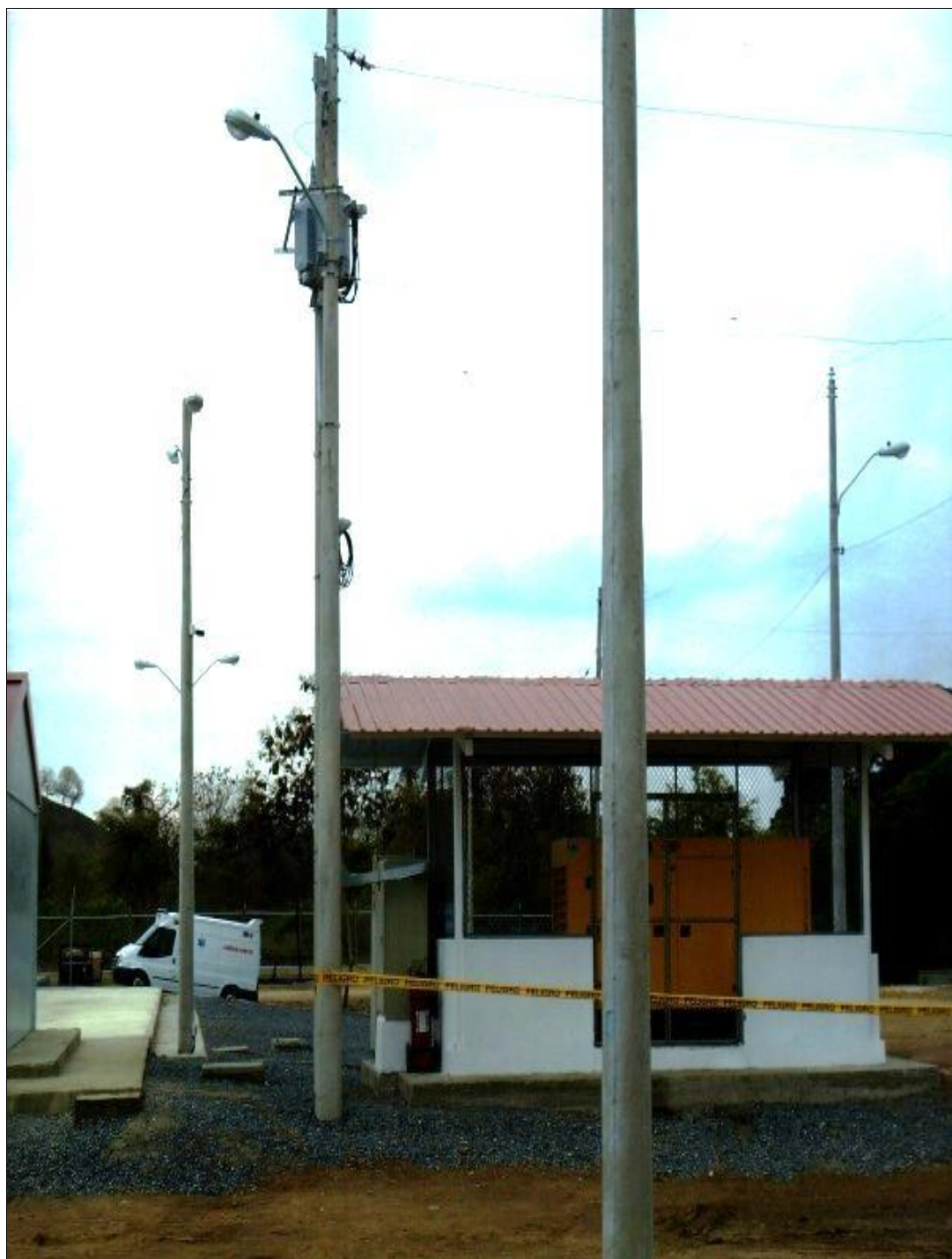
FIGURA # 1 CENTRO DE CARGA
