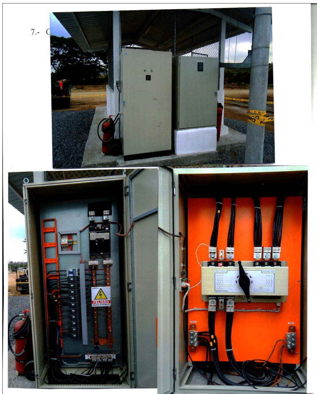
FIGURA # 3 TABLERO DE DISTRIBUCIÓN GENERAL Y TRANSFERENCIA AUTOMÁTICA
