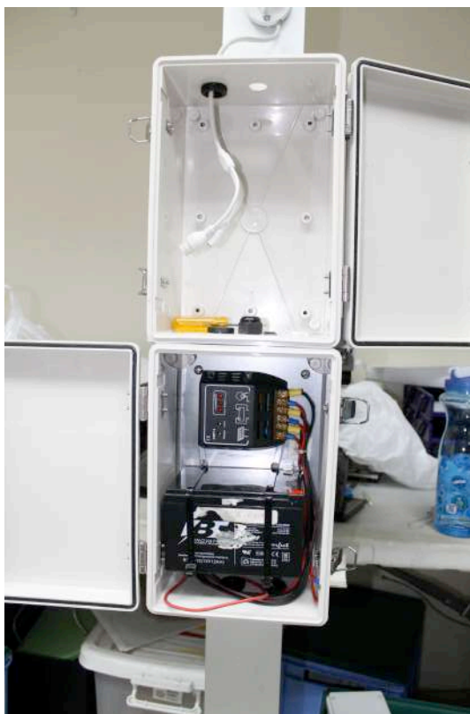
Figura 2.5 Montaje de batería y regulador de carga.
