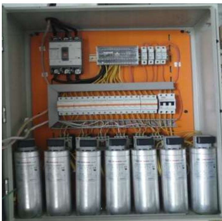
Figura 2.6: Banco de Condensadores (vista interna)
