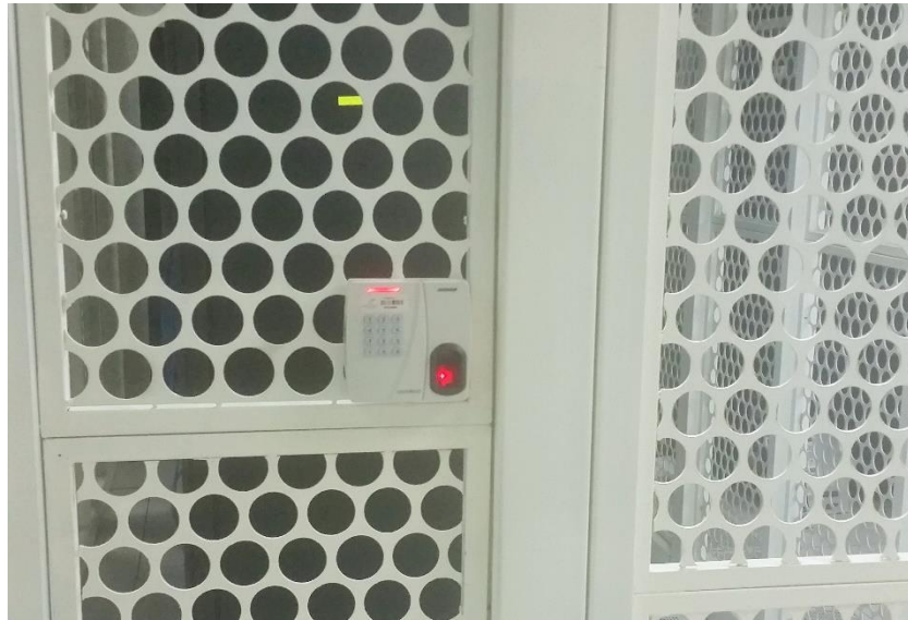
Figura 2.1 Acceso a Centro de Datos a través de huella digital y tarjeta magnética Fuente: Eddy Espinosa
