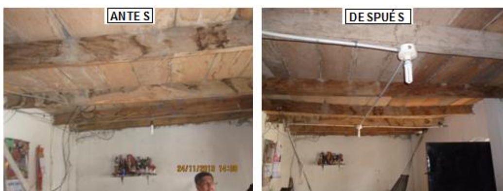
Figura 3. 48: Eliminación de instalaciones peligrosas a través de tuberías
