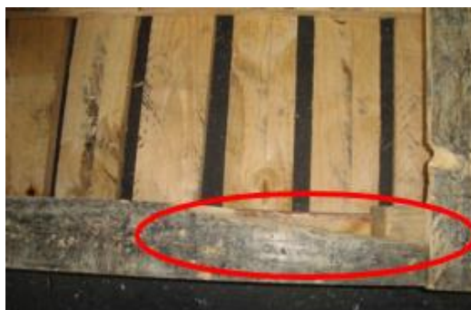
Figura 2.3 Ejemplo Ligero astillamiento en elemento inferior
